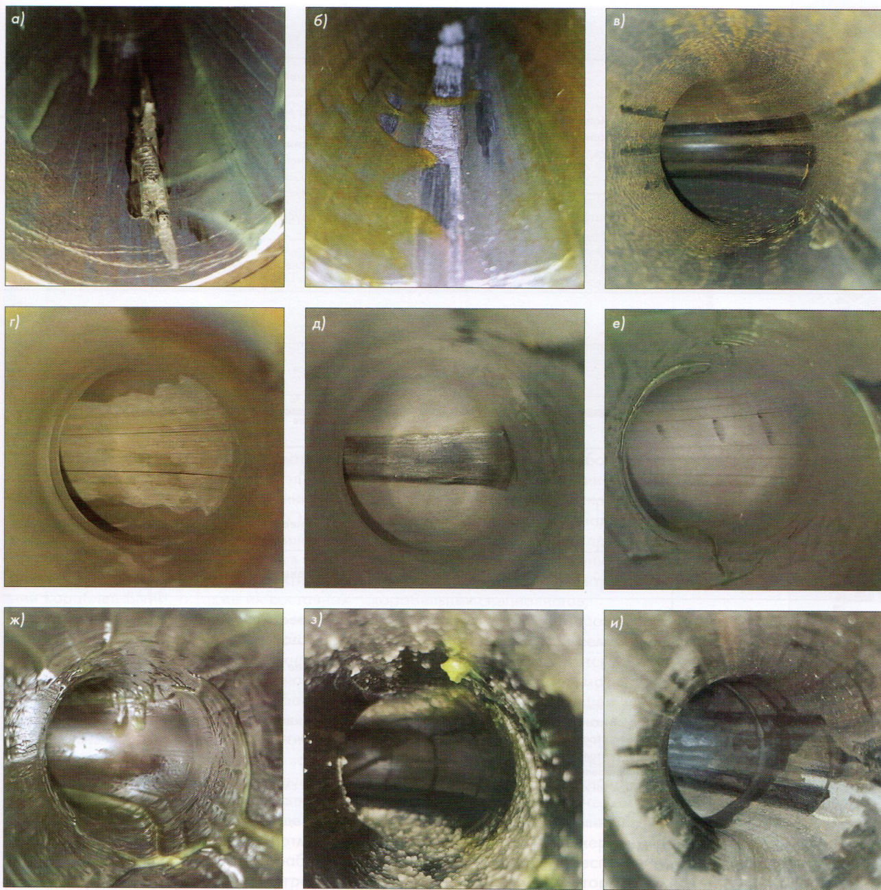
Рис. 4. Следы контакта дорна с внутренней поверхностью трубы:
